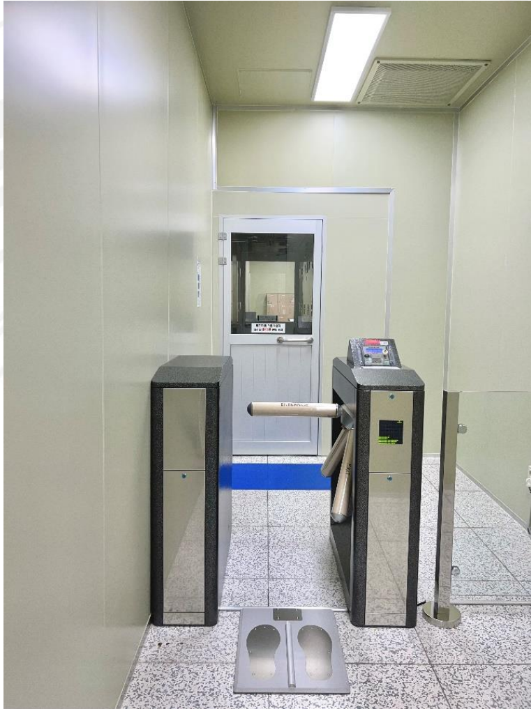
ESD Gate 및 에어샤워 룸
